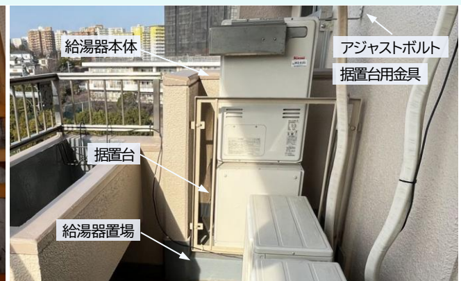
図 7 ベランダ給湯器置場
