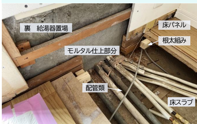
図 5 給湯器・配管－住戸内
