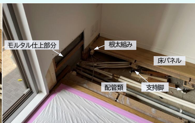
図 6 給湯器・配管－住戸内
