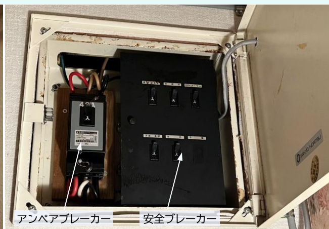
図 17 分電盤（漏電ブレーカーなし。竣工時のもの）
