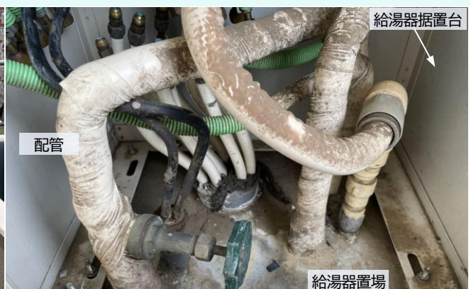
図2 給湯器・配管—給湯器置場
