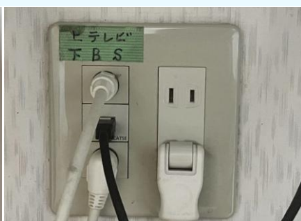
図 17 マルチメディアコンセント
