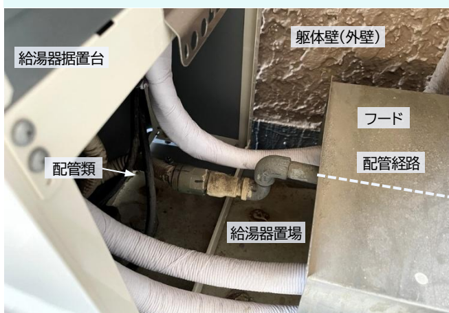
図 3 給湯器・配管－給湯器置場
