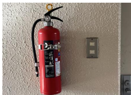
No.1 粉末消火器・ELV ホール
