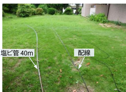
No.2 水中ポンプ・塩ビ管・配線
