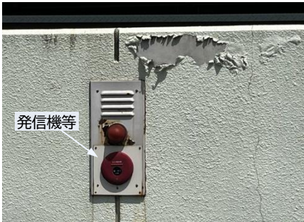
No.2 3 号棟前立体駐車場 1F 外壁中央
